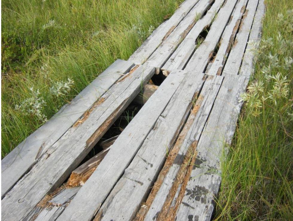
Kuva 20. Pallastuntureiden vaellusreittien pitkospuut ovat paikoin melko pitkälle lahonneita.
